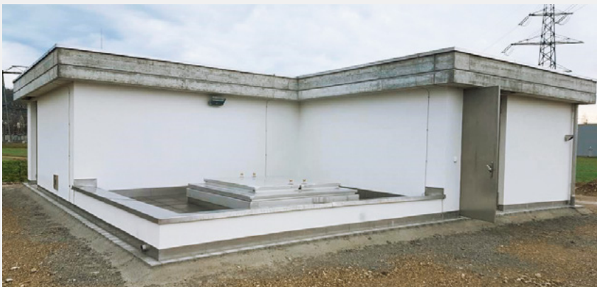
Fig. 14 Pumpenhaus mit einem direkt über dem Brunnen angeordneten Bodentor für den direkten Ausbau der Pumpen.
