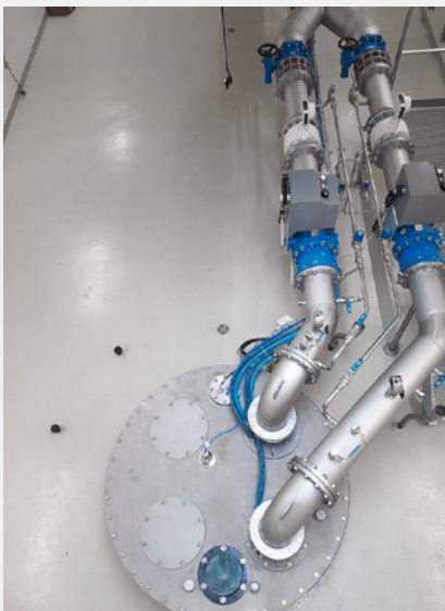
Fig. 8 Brunnen mit zwei Unterwasserpumpen. (BSB + Partner)
